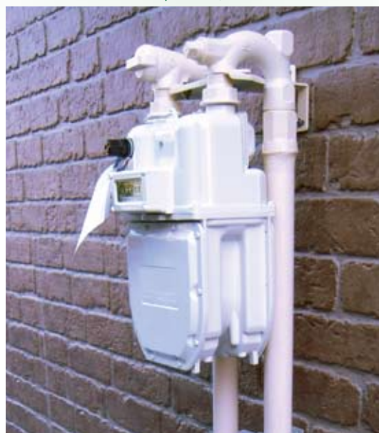
メーター廻りユニット
